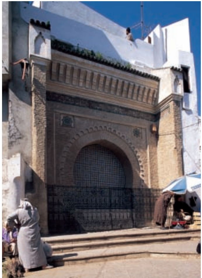
89. Fuente o kna Bab Oqla, recientemente restaurada. سقاية أو قنا باب العقلة التي تم إصلاحها مؤخرًا.
