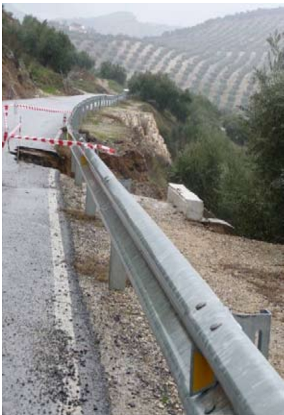
Problemas de erosión en carretera
