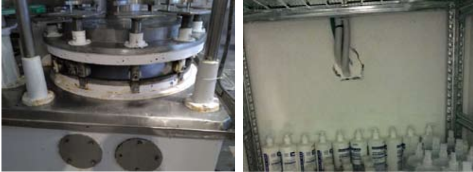
Foto 1. Ejemplos de falta de mantenimiento en equipos
