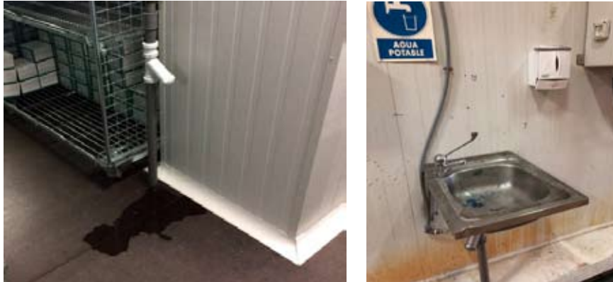
Foto 3. Ejemplos de drenajes y mantenimiento inadecuados
