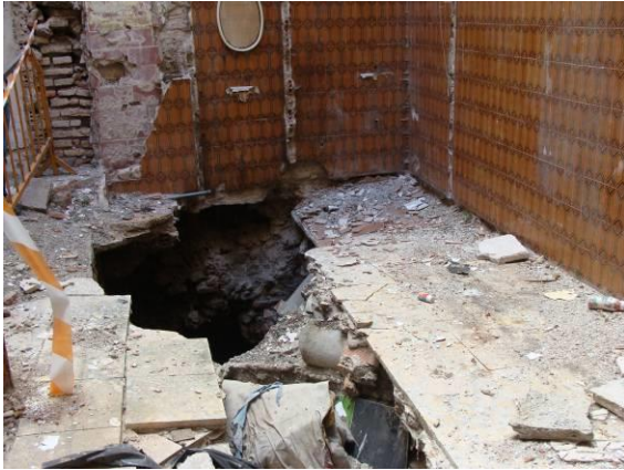
lám. a. Estado del interior del inmueble
