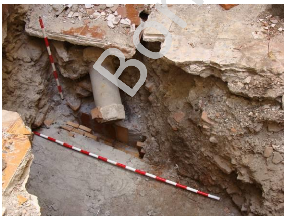
lám. f. trabajos de reposición de la bóveda y acondicionamiento del sector afectado en el interior de la vivienda.
