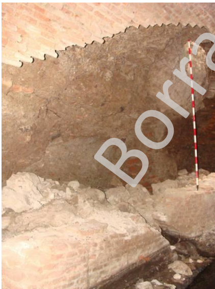
lám. c. Estado previo de la zona afectada por la rotura y derrumbe de la bóveda.
