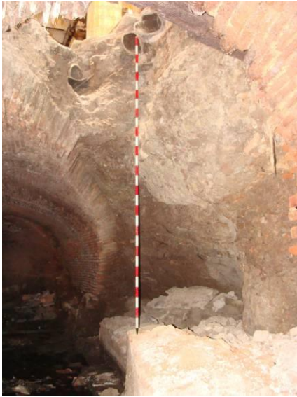
lám. d. Estado previo de la zona afectada por la rotura y derrumbe de la bóveda.
