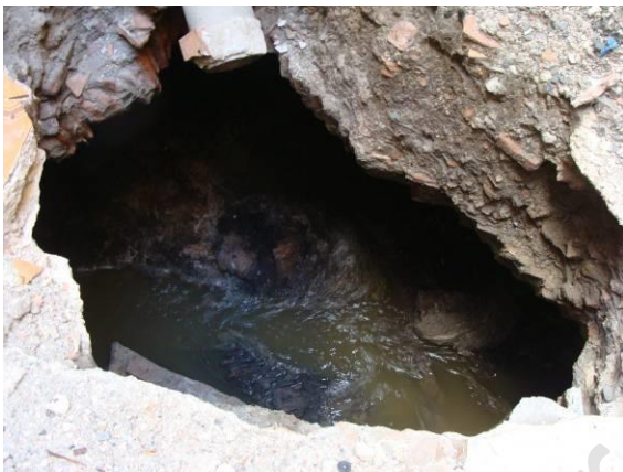
lám. b. Interior del inmueble, estado en que se encontraba la rotura de la bóveda
