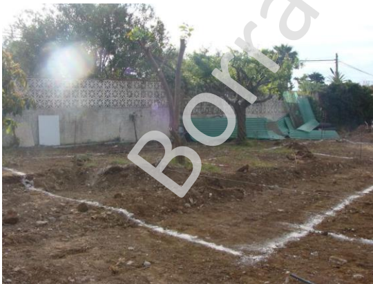
lám. c. Vista general desde el noroeste del espacio destinado al sótano, previo al inicio del rebaje.
