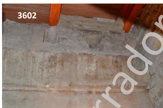
Lámina 27. Detalle del último cambio de techumbre. Su reposición data en el s.XX, realizado mediante vigas en forma de doble T.
