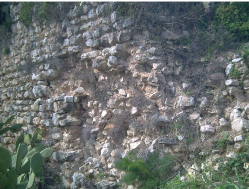
Detalle de las patologías de elemento arquitectónico.
