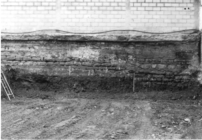
LÁM. VIII: Vista de la muralla. Presenta un aparejo formado por dos hileras de ladrillo y una de sillarejo apoyados en varias hileras de sillarejos y sobre gravas gruesas.
