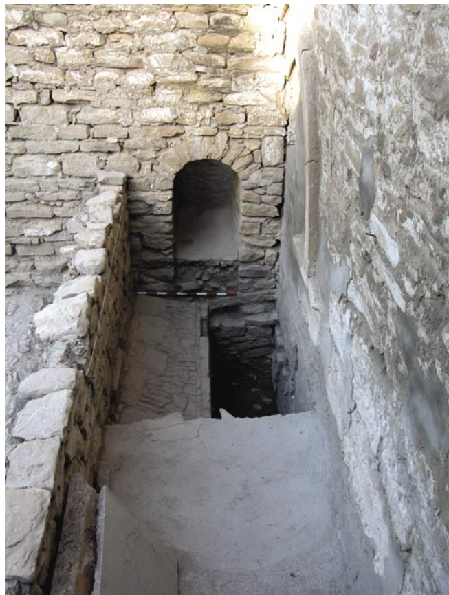
LÁM. IV. Huertos de San Benito. Tercera Fase de la Actividad Arqueológica Preventiva. Corte 3. Sondeo delante de la puerta gótica sellada, dentro del canal de desagüe de la iglesia.
