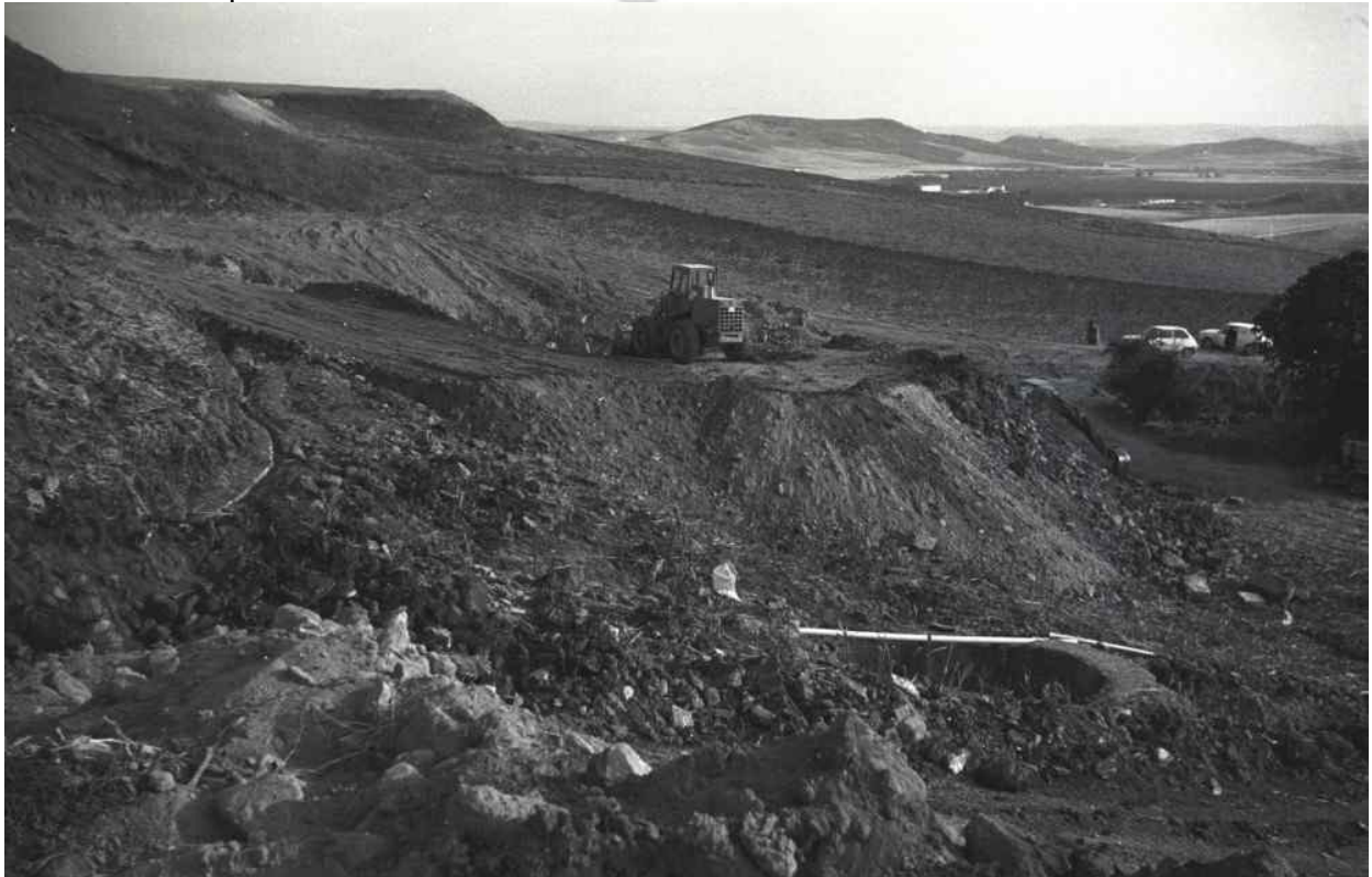
Figura 9. En primer término descubrimiento del pozo de agua romano de la zona conocida como Fuente de Teba durante las obras de canalización del agua de ese manantial a la pedanía de Santa Cruz. © Manuel Martín Bueno.
