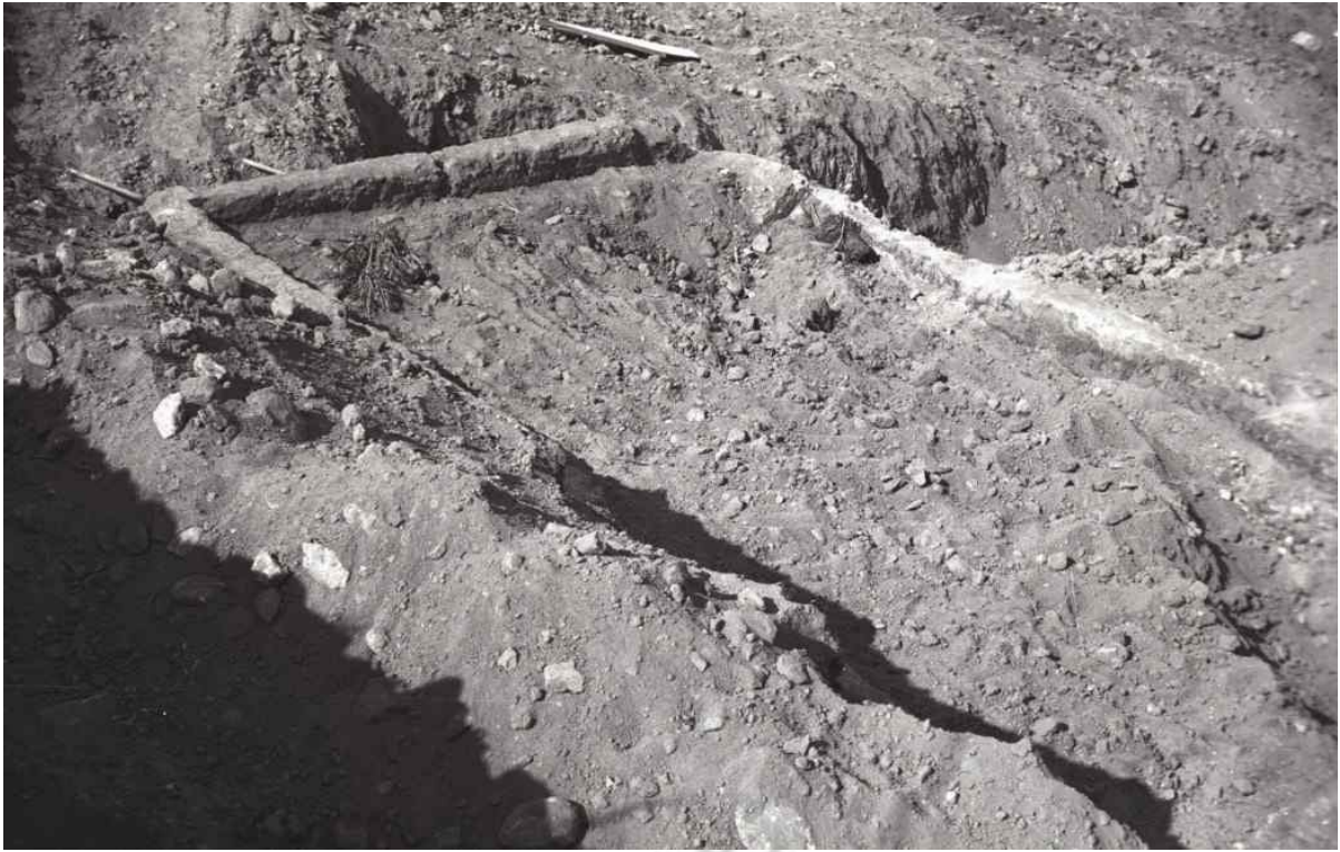
Figura 8. Descubrimiento, en la década de los 80 del siglo XX, de una de las piscinas romana de la zona conocida como Fuente de Teba durante las obras de canalización del agua de ese manantial a la pedanía de Santa Cruz. © Manuel Martín Bueno.
