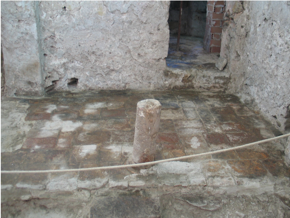
Basa y parte del fuste de columna de posible arco geminado en Sala Fría
