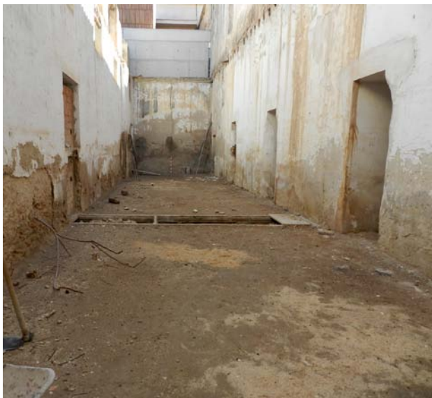
Lámina 1. Estado inicial de la nave anexa al inicio de los trabajos. Vista hacia el sur.
