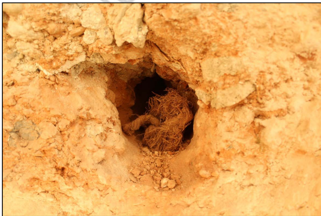
Imagen: Detalle de la cuerda que sujetaba la aguja del encofrado localizada en el mechal UE-008-3N.
