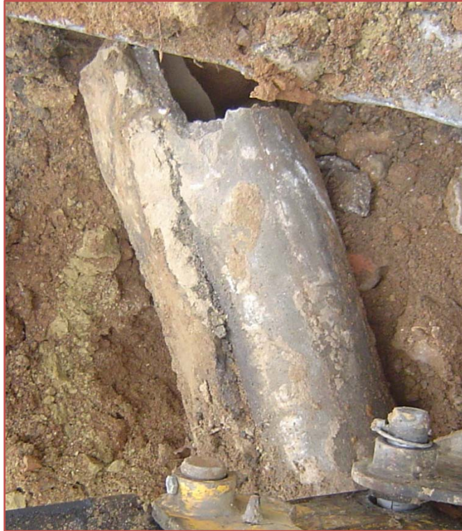
Lám. VIII Tubería de acometida revestida con UE 18, en F 6. Elaboración propia.
