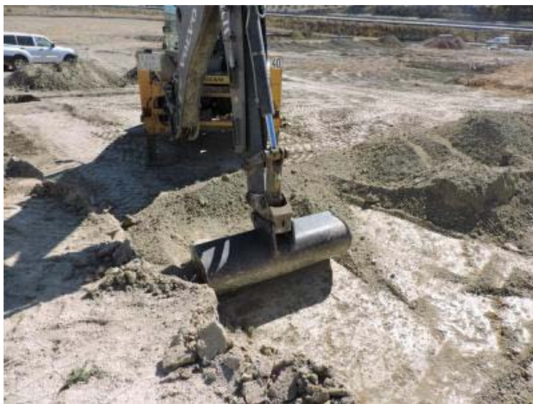
Fot. 2. Labores de limpieza superficial del terreno en el que se debían erigir las naves.
