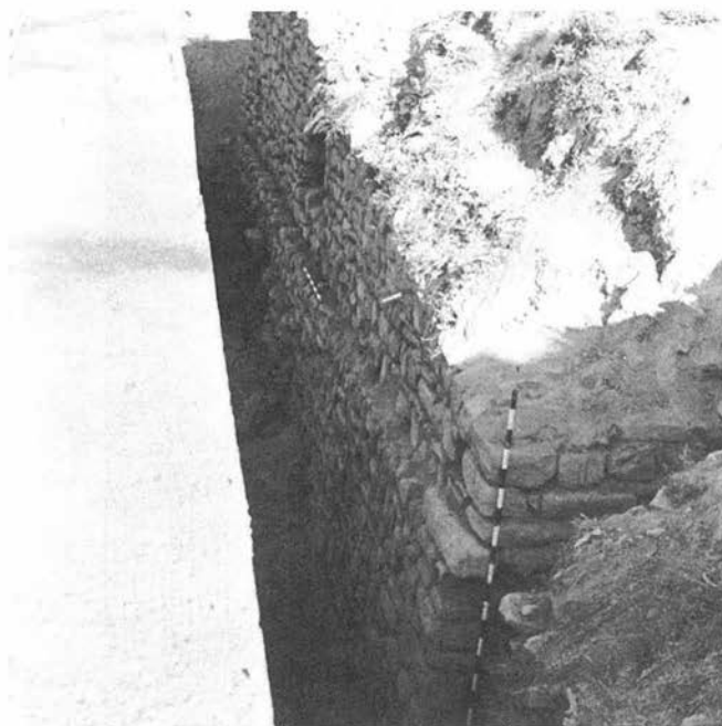
LAM. I. Muralla de Ubeda. Detalle de un aspecto de la «restauración». Lienzo de muralla medieval encofrado por la restauración y documentado en la intervención arqueológica de urgencia.
