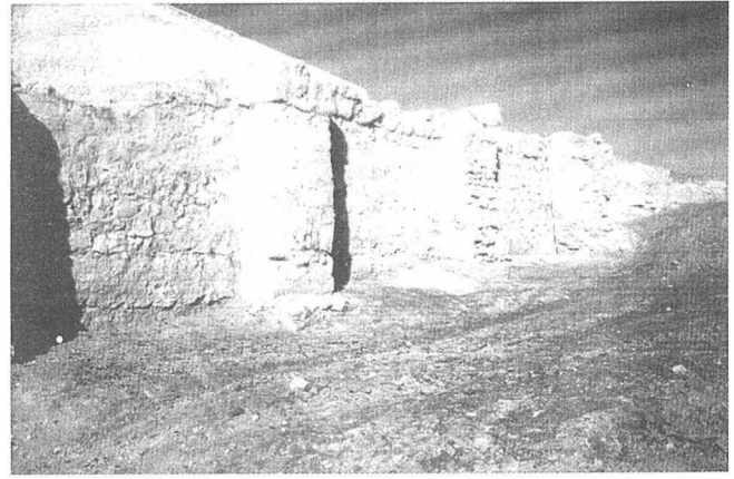
LAM. III. Adaptación topográfica del paramento externo del muro oriental, reforzado por la adición de contrafuertes.
