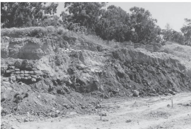
LAM. VIII. Area este del talud tras su desprendimiento.
