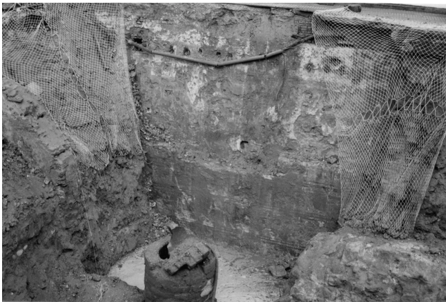
LÁM. VI. Muralla del Adarve del Río junto a la Puerta del Puente donde se conserva un alzado de 5 metros.
