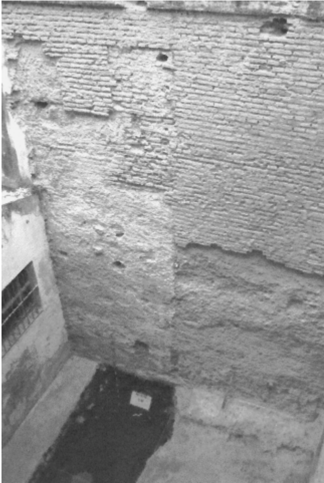
LAM. I. Corte VI. Conservación bajo superficie de la torre y la muralla islámicas. Se encuentran alteradas por la intrusión de atarjeas y pozos negros postmedievales.
