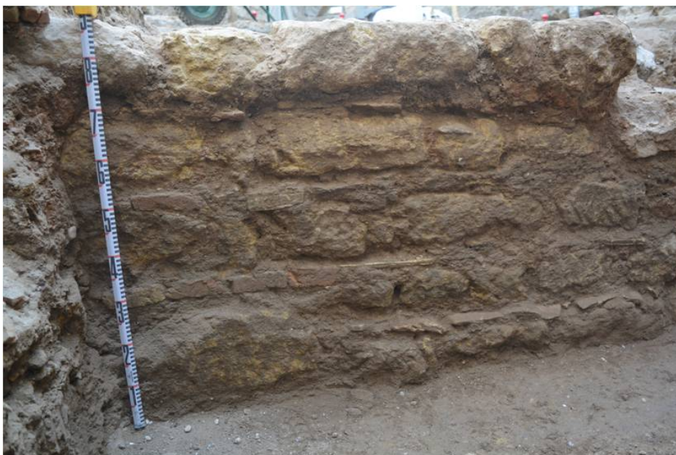
Lám. V. Detalle de la fábrica a base de sillares cuadrangulares de calcarenita y recalzos con ladrillo del muro UE:-35. Vista desde el oeste.
