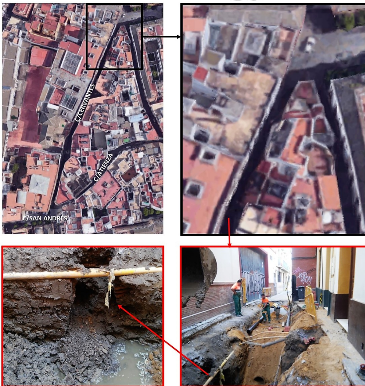
FIGURA 13. Vista general y detalle de las zanjas de instalaciones frente al portal del nº 14 de la calle Cervantes.
