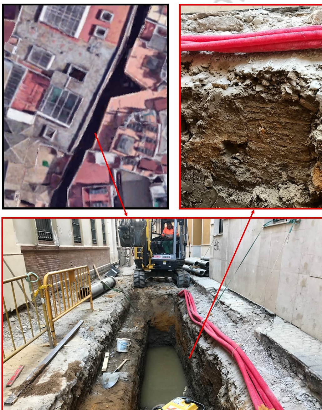
FIGURA 8. Vista general del proceso de excavación mecánica para la instalación de redes junto a la línea de fachada del nº 10 de la calle Cervantes. En el perfil Este se documenta la cimentación de la línea edificatoria moderna, anulada en pleno siglo XX.
