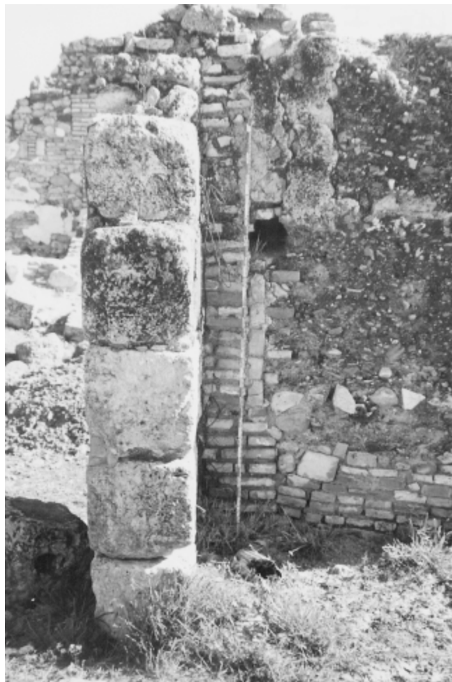
LÁM. I. Cortijo La Ramira. Yacimiento SE-F. Sillares romanos reutilizados en la construcción del Cortijo.
