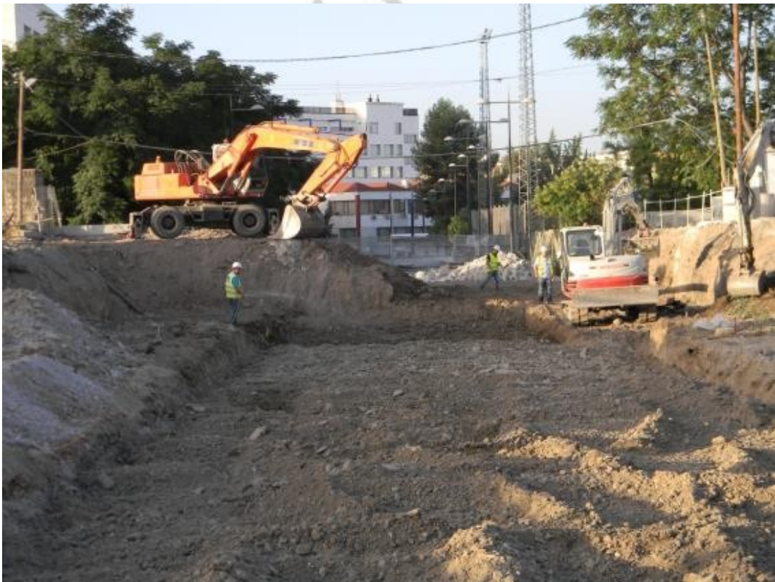
FIG. 13: CONTINUACIÓN DE LOS TRABAJOS DE EXCAVACION EN LA ZONA DE LA PARADA “ESTACIÓN EN FERROCARRIL” Y SU UNIÓN CON EL CAMPUS DE FUENTE NUEVA
