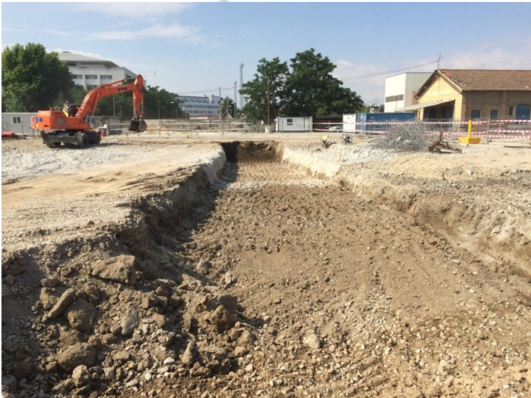
FIG. 11: INICIO DE LOS TRABAJOS DE EXCAVACION EN LA ZONA DE LA PARADA “ESTACIÓN EN FERROCARRIL”
