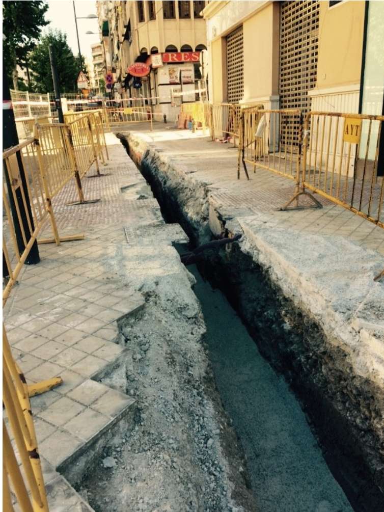
FIG. 8: VISTAS DE LA ZANJA ABIERTA EN AVENIDA DE ANDALUCES PARA DESVIO DE SERVICIOS AFECTADOS
