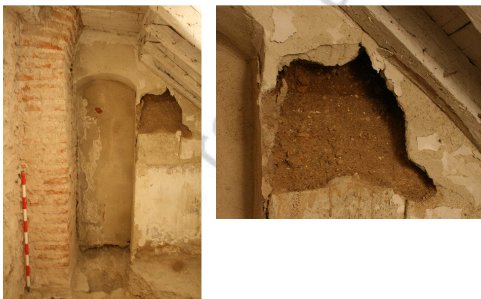
Vista general del hueco y detalle del estado del tapial
