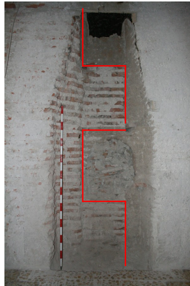
Alzado de la Fachada SO (exterior): Cajones de tapial delimitados por ladrillos
