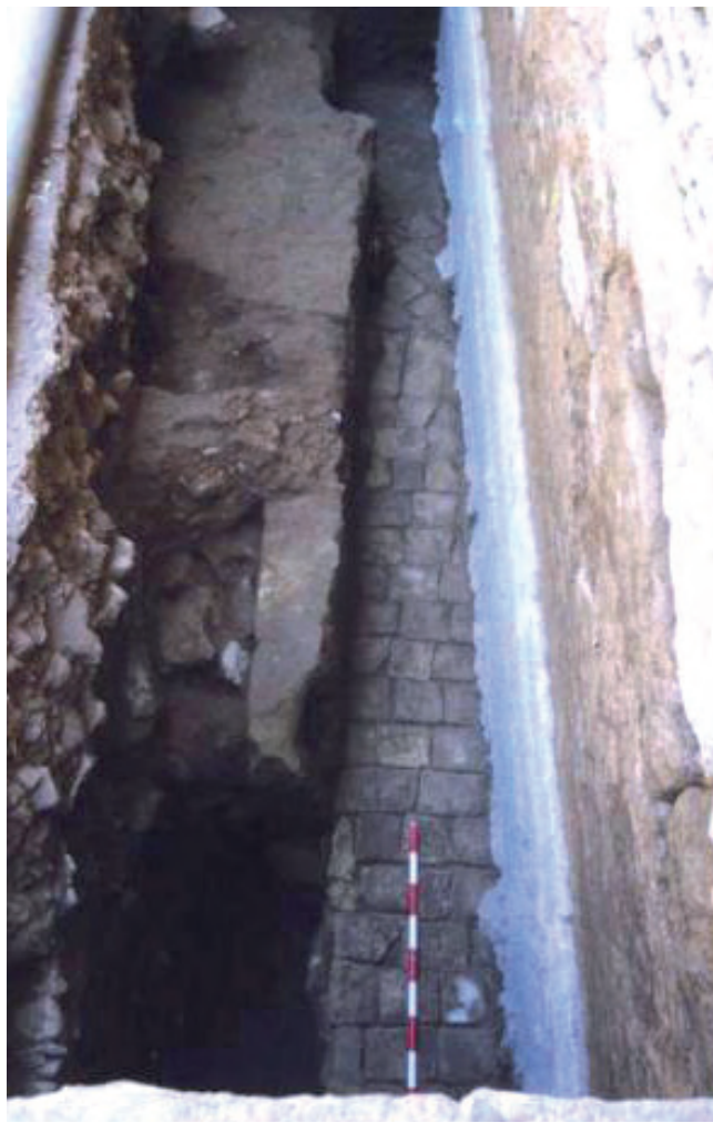
Lámina II. Corte 1. A la derecha, el muro de fachada de las Caballerizas, a continuación, su cimentación y la zanja que rompe las estructuras de tapial anteriores.
