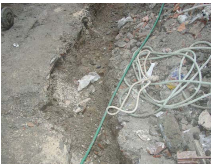
Lámina VII. Vista de una arqueta en funcionamiento
