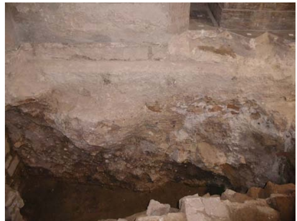
Lámina V. Detalle de la cimentación del muro occidental de la capilla realizado mediante vertido de mortero con ladrillo y cal en fosa perdida en contraposición al cimiento labrado que se observa en el borde izquierdo de la Lámina 1.
