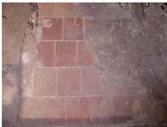
Lámina II. Restos conservados de la solería original de la mezquita con una orientación y a una cota distintas a la del resto de la sala de oración.
