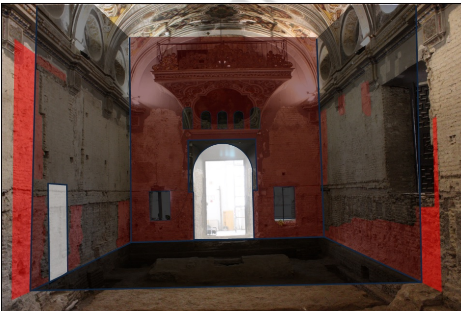
Lám. I. Capilla doméstica. Dimensionado interior de la qubba mudéjar. En rojo, estructuras originales conservadas.
