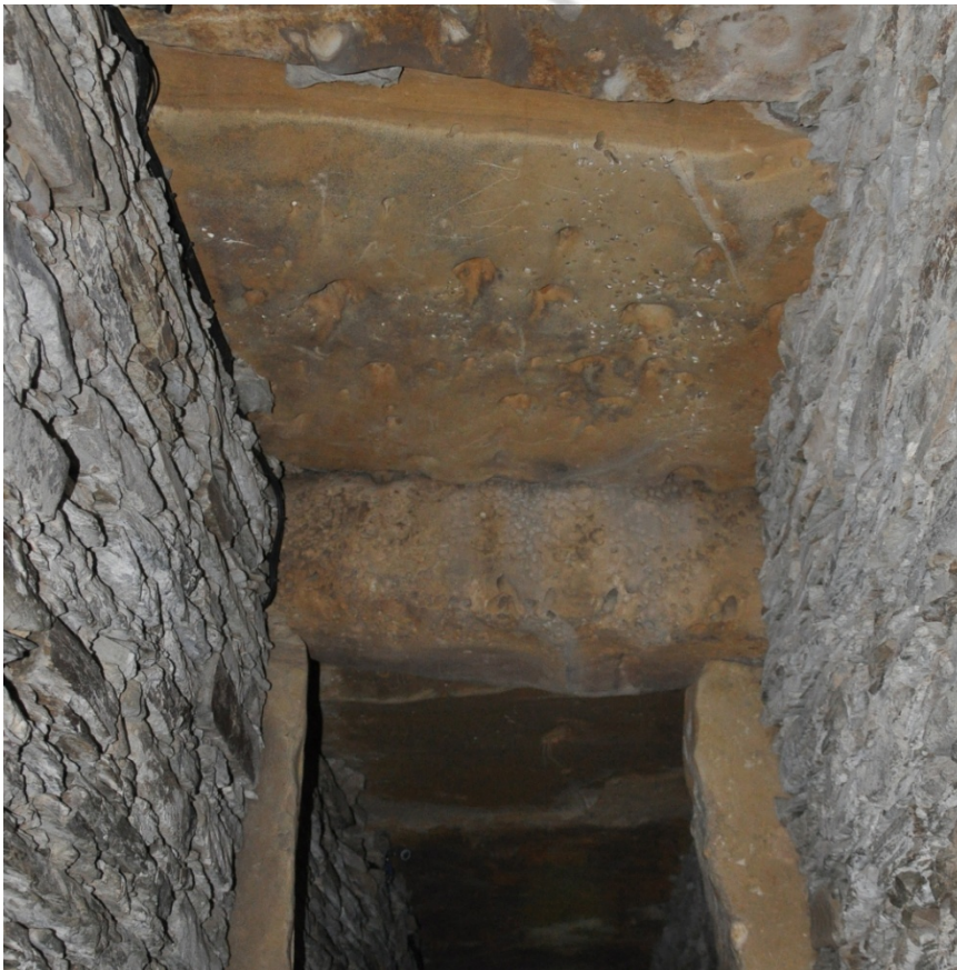
Lámina 1.- Dintel y losa de cubierta de La Pastora con huellas de bioerosión marina.
