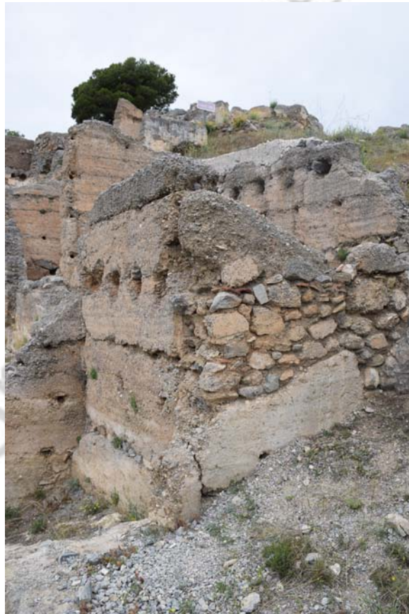
Figura 8. Reparación con piedras, ladrillos y fragmentos de tapial reutilizados de la primera fase. Segunda fase superpuesta. Edificio 8
