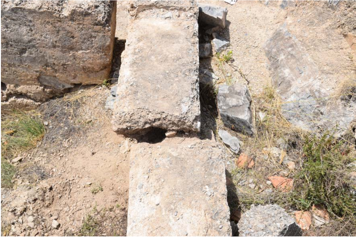
Figura 7. Desplome de un muro del Edificio 30
