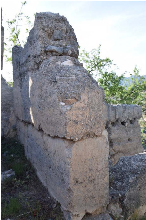
Figura 6. Bloque de tapial desplazado de su posición original. Edificio 3
