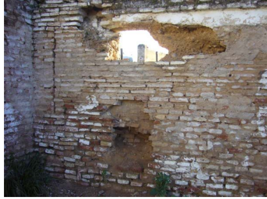
Figura 27. Detalle del estado de conservación de la tapia
