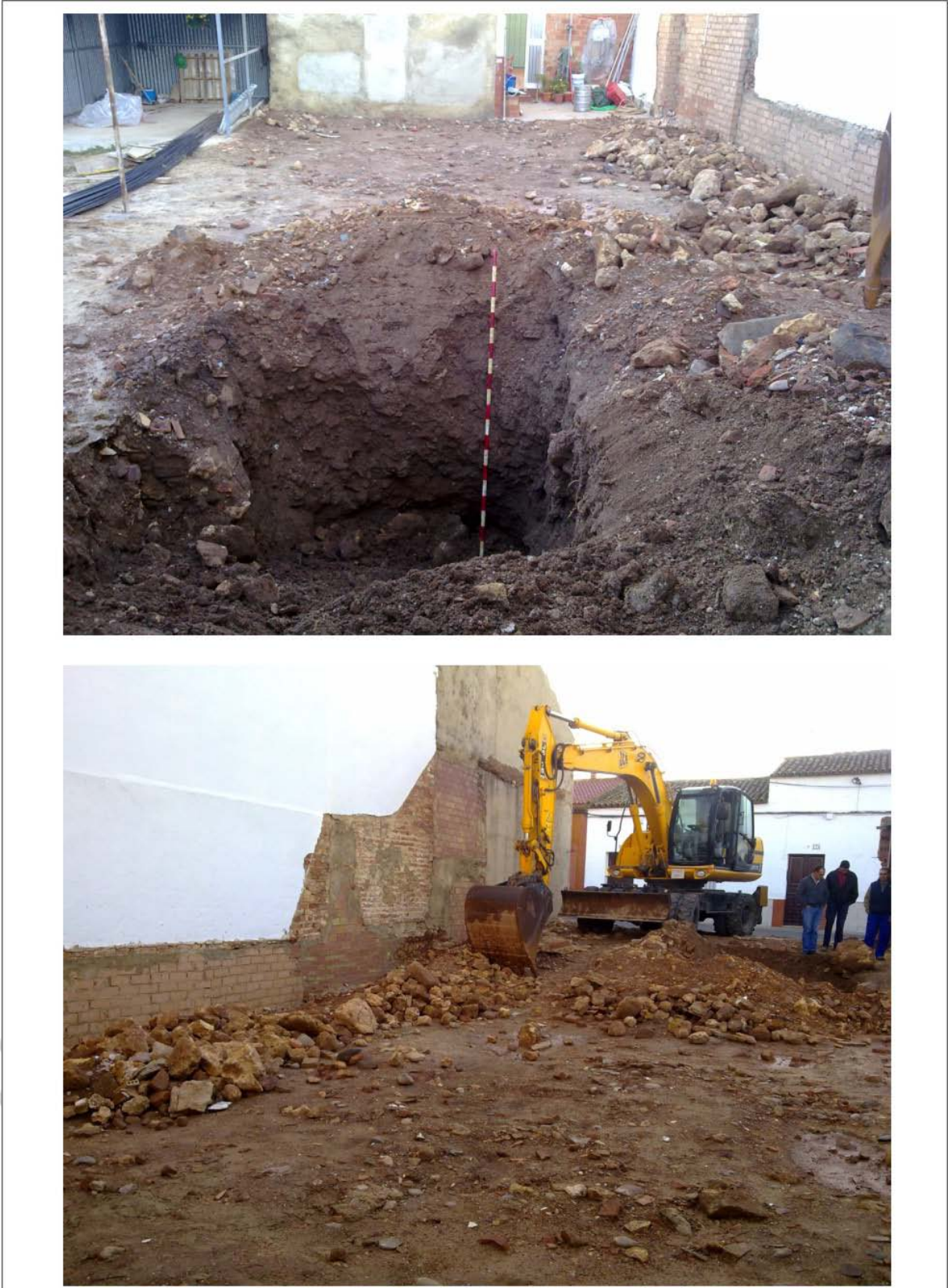
LÁMINA I. Ejecución de Calicata para el estudio Geotécnico con carácter previo a la Actuación Arqueológica ( arriba ). Inicios de los trabajos en el Solar. Vista desde el Norte (abajo)
