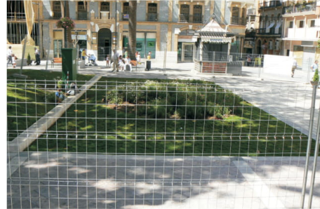
1.2. VALLA DE SEGURIDAD
