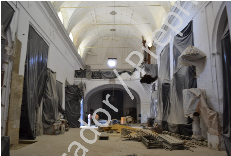
Lám. 1 Vista general de la nave central de la Iglesia antes del comienzo de la actividad.
