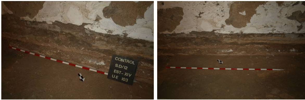
Lám. 28 y 29. Detalle del rebaje de la estancia en el paramento sur. Obsérvese la superposición de enlucidos (original del s.XVI y su reparación)
