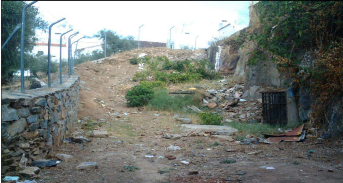
Lam. 3 Tramo 2 del Camino del Chorrillo. Estado previo al comienzo de las obras.
