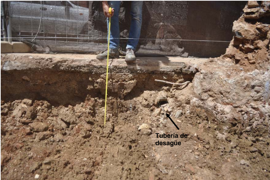
Figura 7. Detalle de la zona de fachada en la que se aprecia el rebaje realizado y la presencia del depósito de tipo constructivo localizado en la base de la excavación y la tubería de saneamiento.
