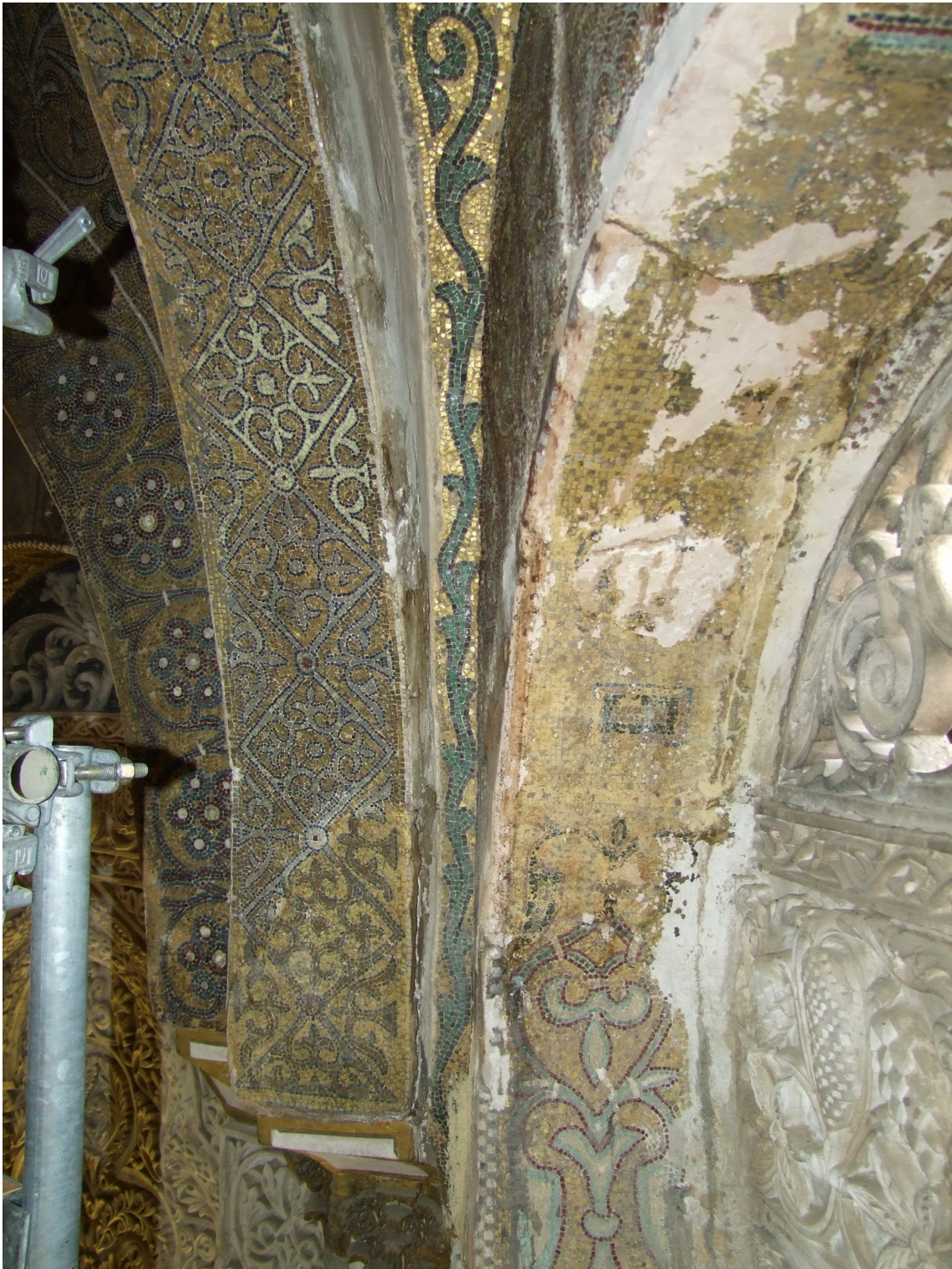
Figura 11: Estado de conservación de la decoración en la nervadura de la bóveda central.
