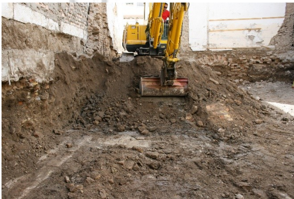
Lám.10. Otra maquinaria en las labores de rebaje. Se localiza parte de una estructura hidráulica (S. XV-XVI).
