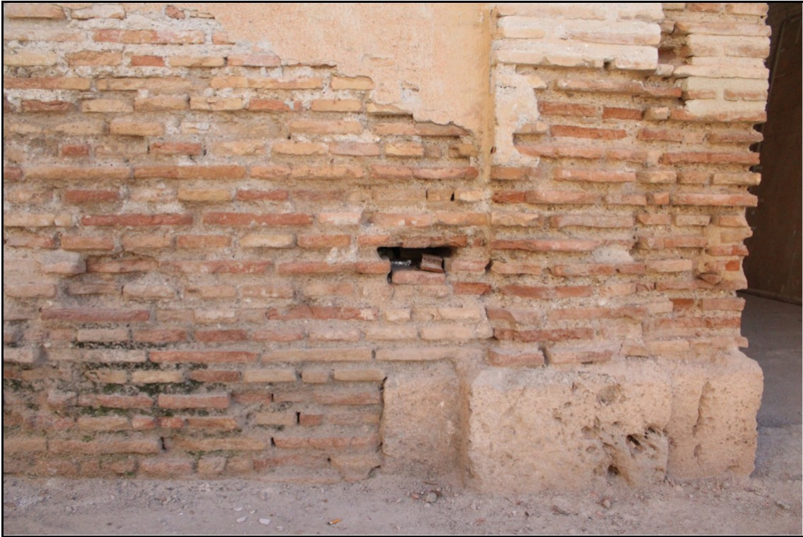
Imagen: Estado de conservación de la fachada oeste.
