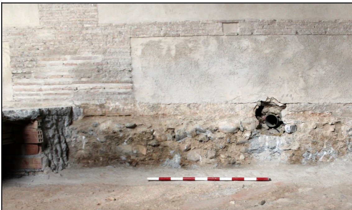
Imagen: Cimentación de argamasa sobre la que se alza la fábrica de cajones y ladrillo.
