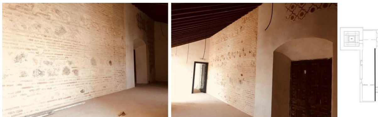
FIGURA 3. Paramento oriental en planta alta de las Dependencias Parroquiales tras la restauración de su fábrica
