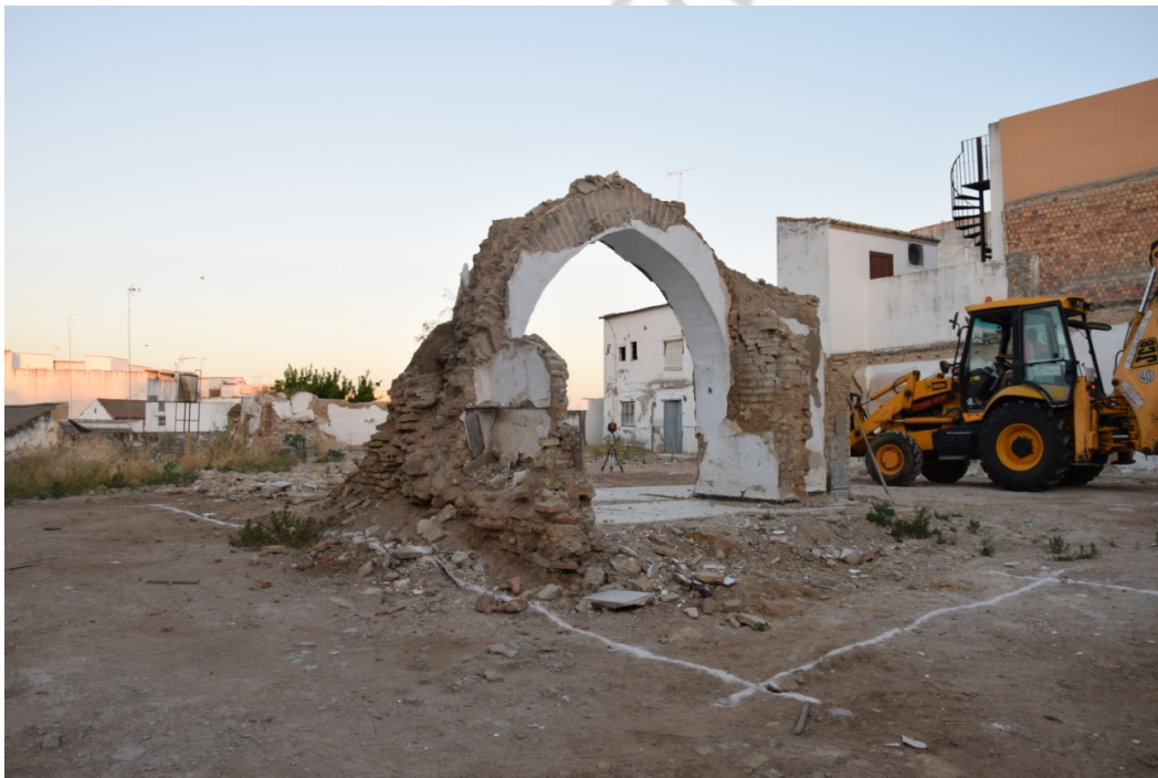
Figura 2. Día de inicio de los trabajos. Imagen del solar con el arco bajomedieval que se ha preservado para integrarlo en la casa.
