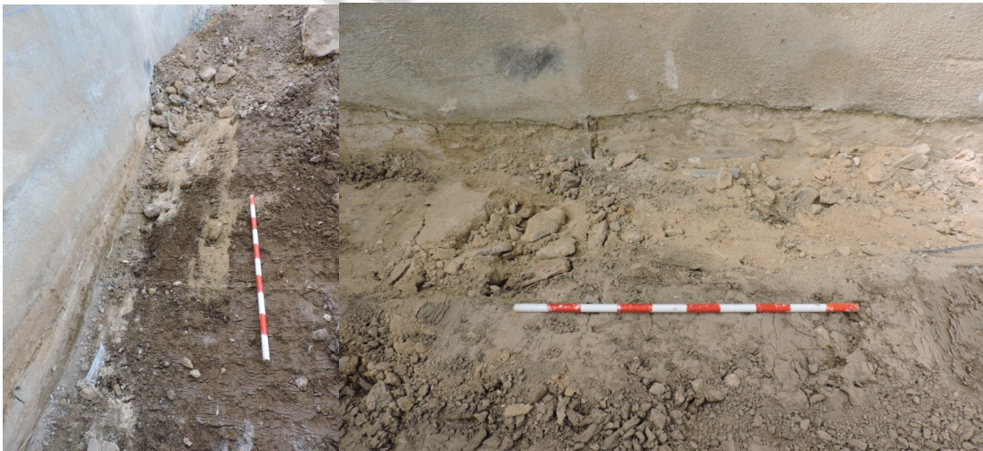
Lám 5 y Lám 6: Zanja de cimentación del edificio situado al norte del solar y al sur
