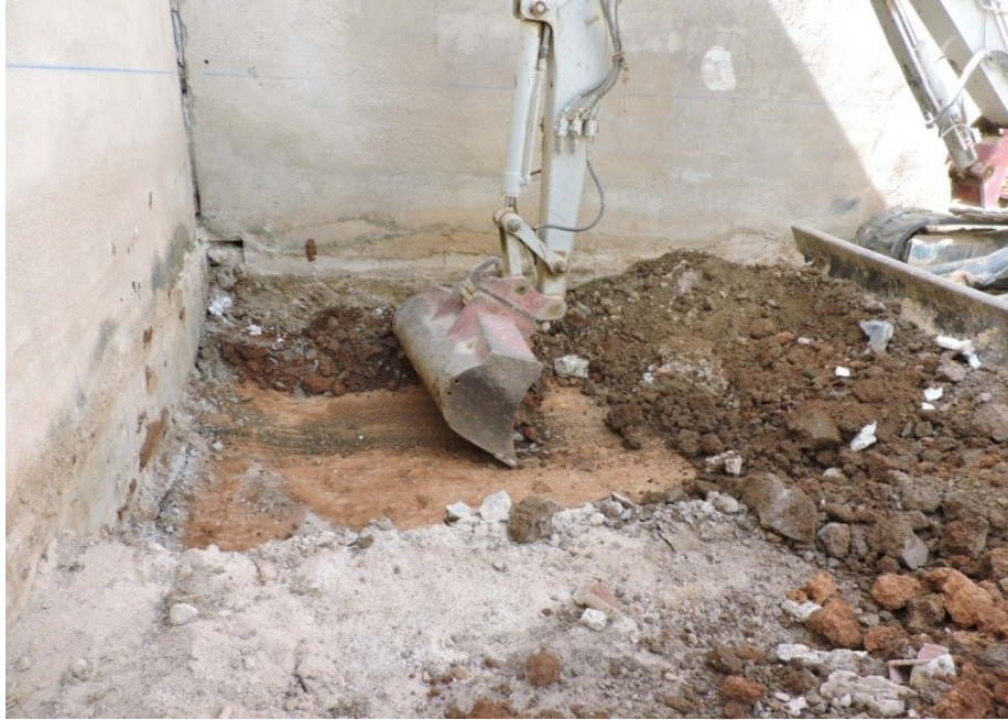
Lám 4: Desmonte de la unidad sedimentaria 2 (tierra de cultivo) y vista del sustrato geológico
