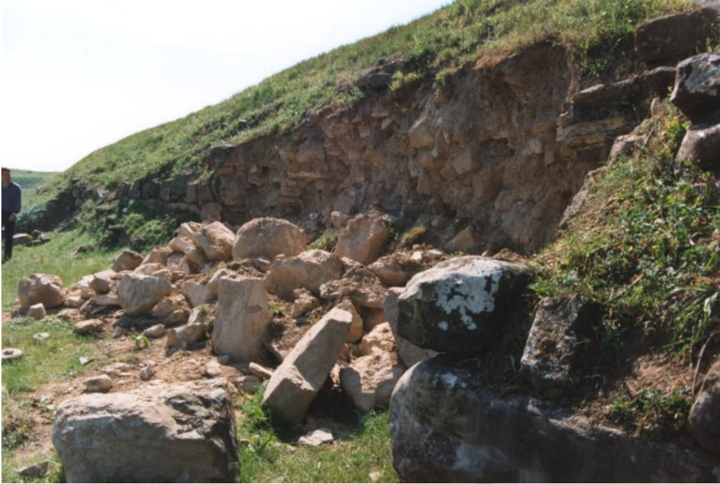
LAM. I- Derrumbe de la muralla. Año 1997
