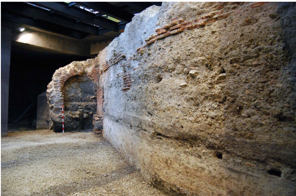
Fig. 13-Imagen de la fascies externa de la muralla resaltando las fábricas de tapial y el colector adosado en el S. XVIII-XIX.
