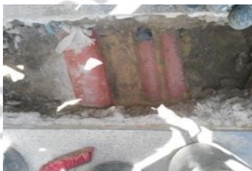
Vista de las canalizaciones actuales
