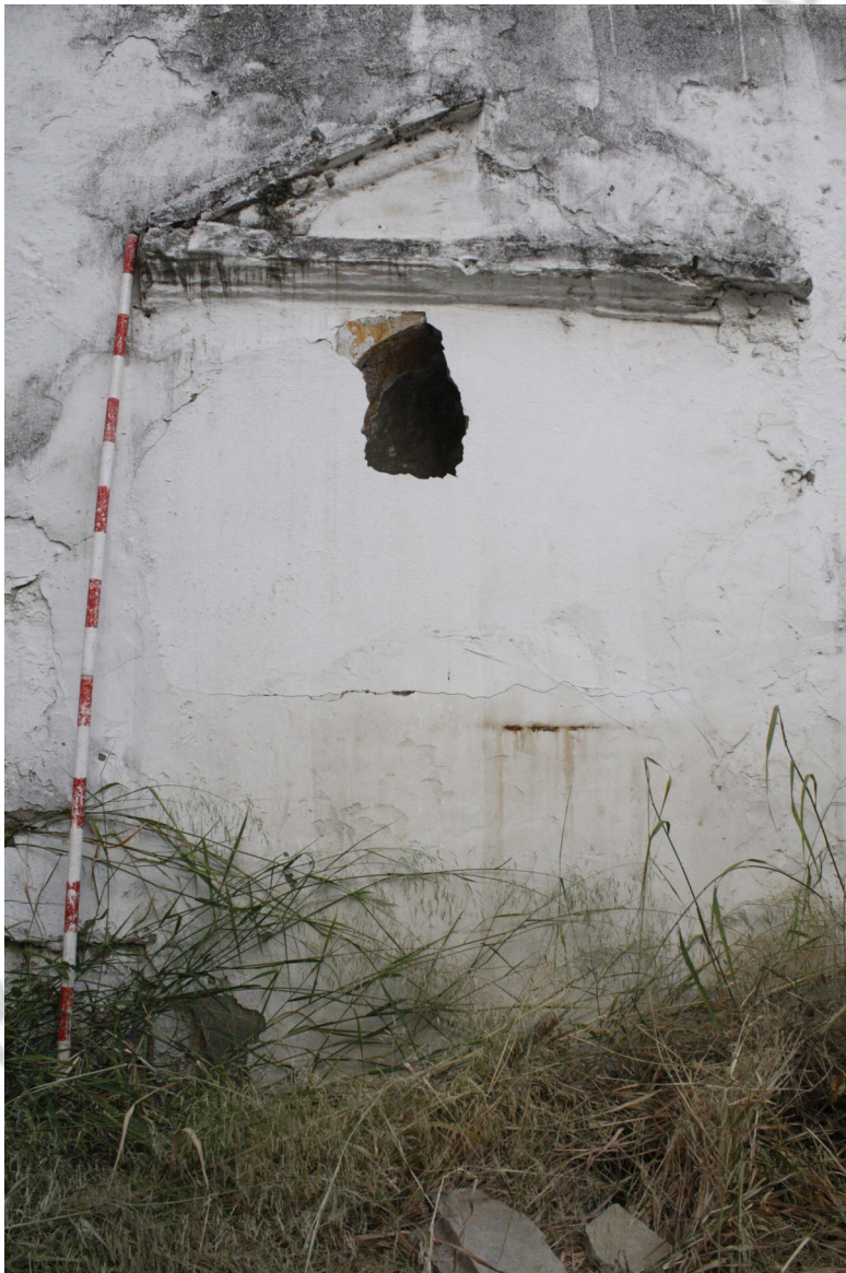
Figura 7 Pozo amortizado en medianera
