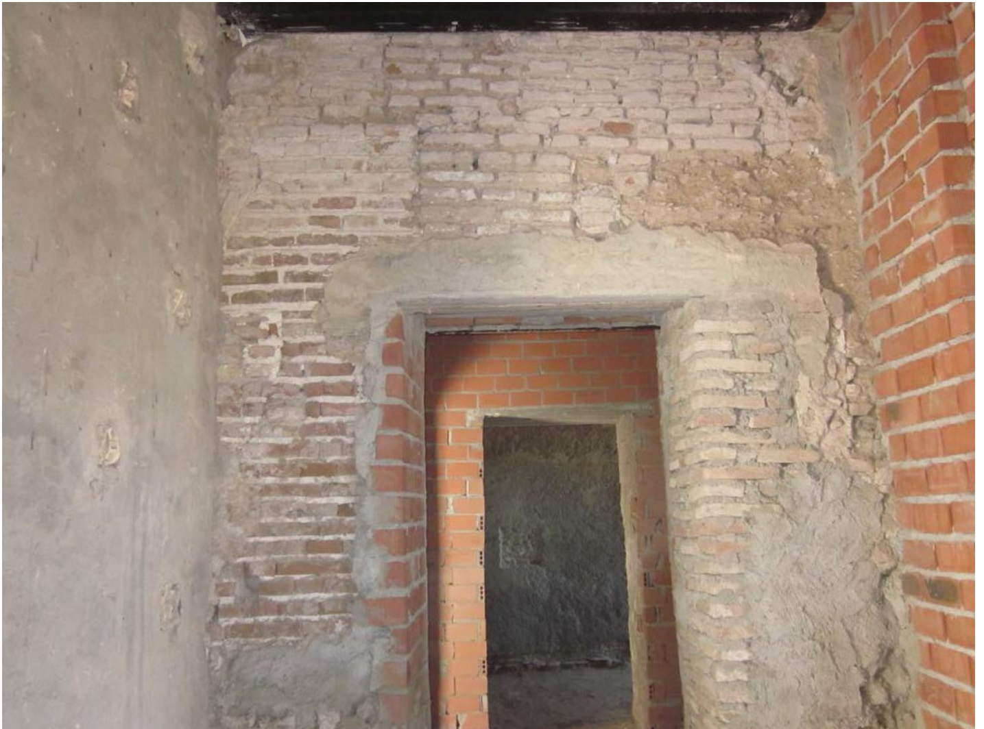
Figura 1. Imagen de la fábrica 21 (izquierda) y su rotura por el muro 18 (línea roja).
