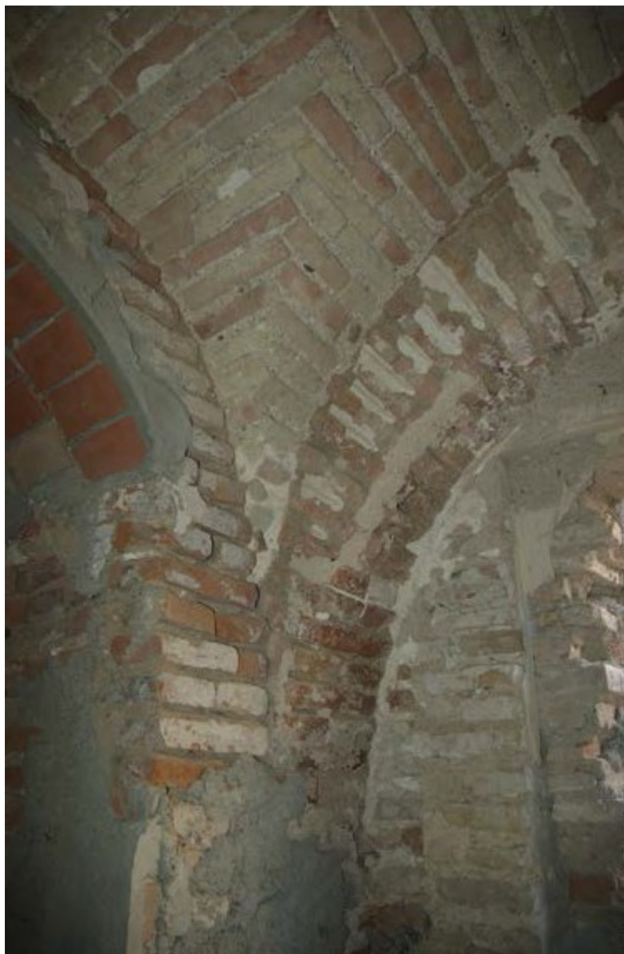
Figura 2. Contacto dentro de la estancia 9. A la izquierda traba entre 12 y 21, y se define el arco 25. La mocheta actual y las bóvedas de arista son posteriores
