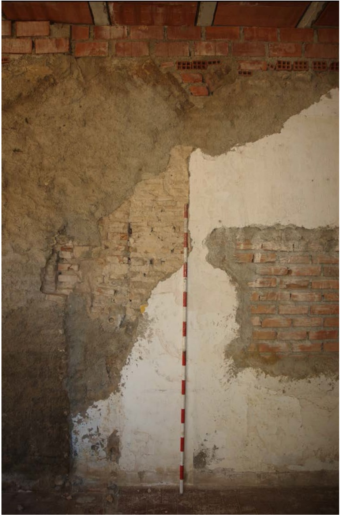
Figura 5. Restos del pilar y la rosca del arco central.
