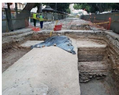
Lámina 4.- Muro este (U.E. 10) seccionado por el colector.
