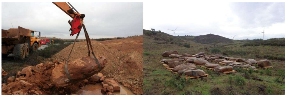
Figura 5. Trabajos de recuperación, traslado y conservación preventiva de los elementos megalíticos registrados en actividad de urgencia de La Torre-La Janera.
